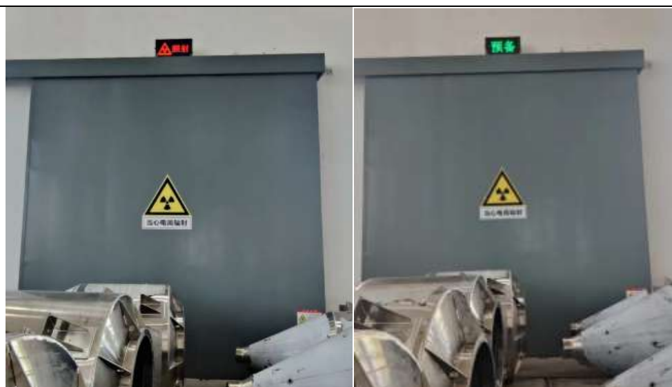
(b) 防护大门处电离辐射警告标志及工作指示灯
